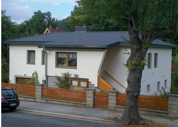
Auf dieses, sich von einem Ziegeldach optisch nicht unterscheidende, neue Metalldach hat Familie Thomas aus Freital 30 Jahre Materialgarantie. Beidseitig schützt die Platten eine Alu-Zink-Beschichtung. Mit Acryl-Harz ist die Dachhaut zusätzlich versiegelt.
